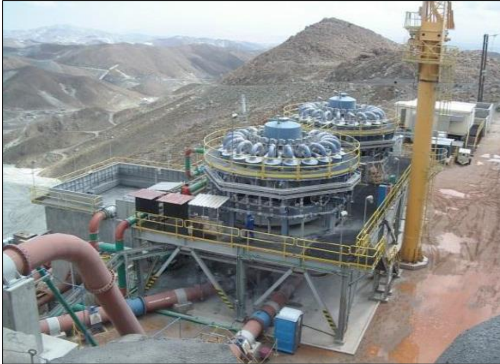
Figura 41: Baterías de ciclones de relaves en una minera del sur del Perú [16].
