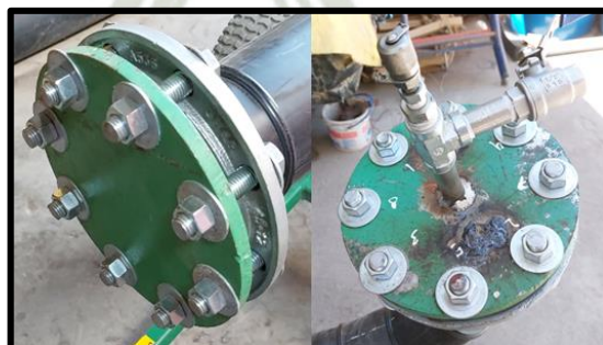
Figura 126 – Extremos unidos con las bridas ciegas, conexión para el Data Logger 6 y bomba DSY-60.
