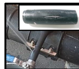
Figura 130 – Tubería de 20 mm reventada a 505 psi. Fuente: Registro fotográfico personal.
