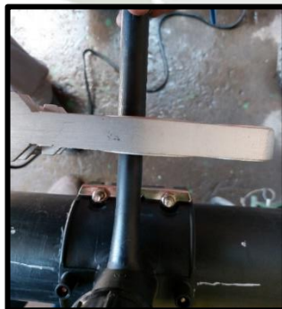
Figura 101 – Calentamiento de las áreas transversales de las tuberías de 20 mm. Fuente: Registro fotográfico personal.
