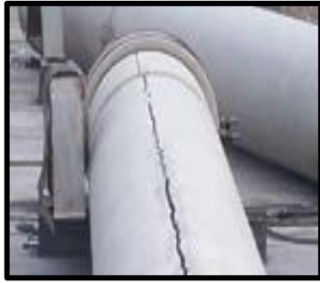
Figura 1 – Tubería de 16” de diámetro de hormigón agrietada.
