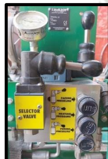
Figura 68 – Bloque de manifold hidráulico del McElroy Rolling 28. Fuente: Registro fotográfico personal.
