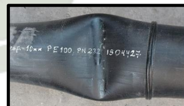
Figura 119 – Deformación en la tubería de 110 mm de diámetro por estrangulamiento. Fuente: Registro fotográfico personal.
