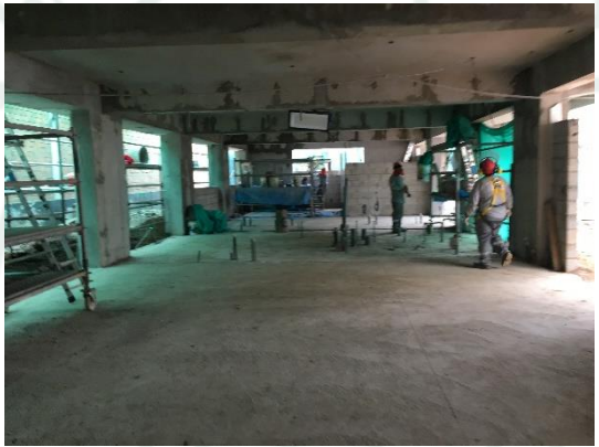
Fotografía N° 3: En las vigas del 2do piso del Activo 419 se visualizaron espacios de coloración resaltante, al respecto el contratista señaló que se realizaron sobre esta reparación por segregación.
