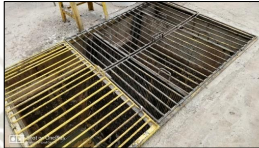
Figura 2: Cámara de rejillas de la PTARD en la U.O.
