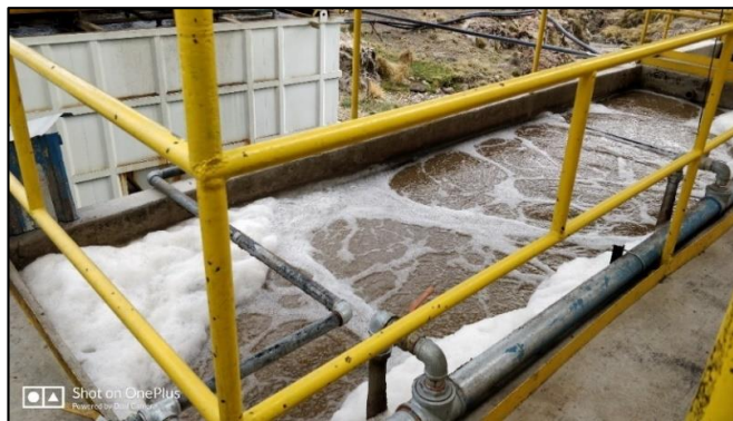
Figura 8: Interior de reactores biológicos de la PTARD dentro de la U.O.
