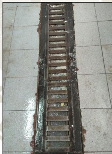
Figura 16: Canaletas y sus rejillas, comedores obreros en la U.O.
