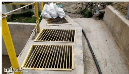
Figura 3: Cámaras desarenadoras de la PTARD dentro de la U.O.
