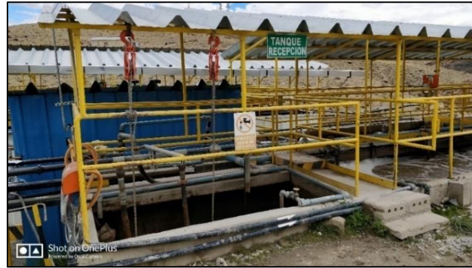
Figura 4: Tanque de recepción de agua residual de la PTARD dentro de la U.O.
