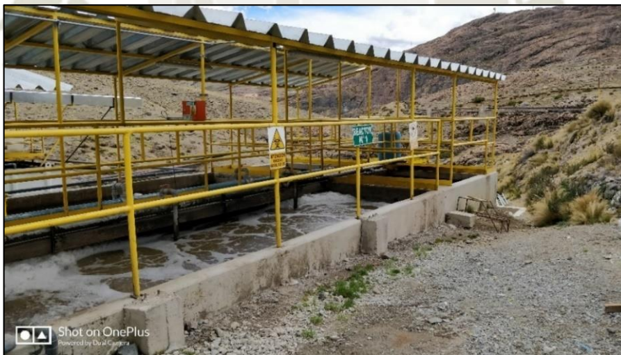
Figura 7: Reactores de la PTARD dentro de la U.O.
