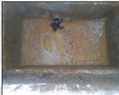
Figura 17: Trampa de grasas del en la U.O. sin limpieza.
