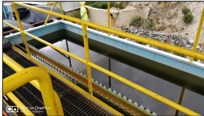
Figura 11: Clarificador dentro de la PTARD en la U.O.
