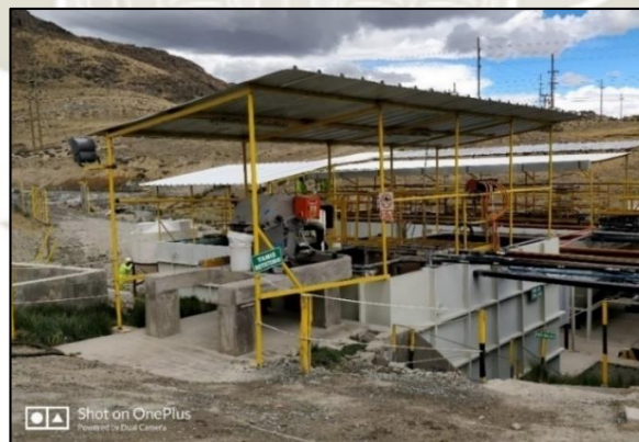
Figura 5: Ecualizador de la PTARD dentro de la U.O.
