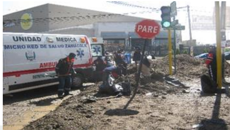
Fotografía 9. Vía afectada ubicada en la Av. Aviación C.C. febrero 2016 Fuente: Obtenido de (SGGRD, 2016)
