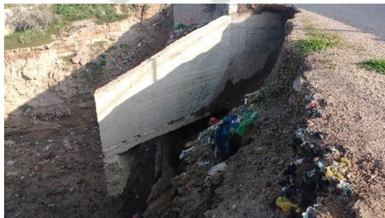
Fotografía 5. Puente afectado ubicado en Villa Canteras C.C. febrero de 2007
