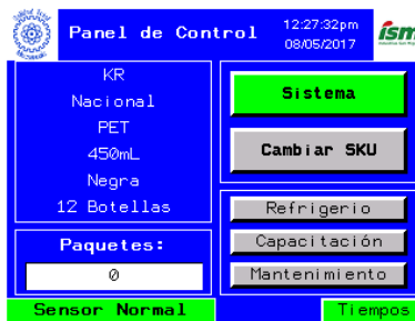
Figura 5.64. Panel de control con el sistema activado
