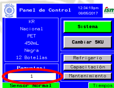
Figura 5.67. Contador de producto en el panel de control
