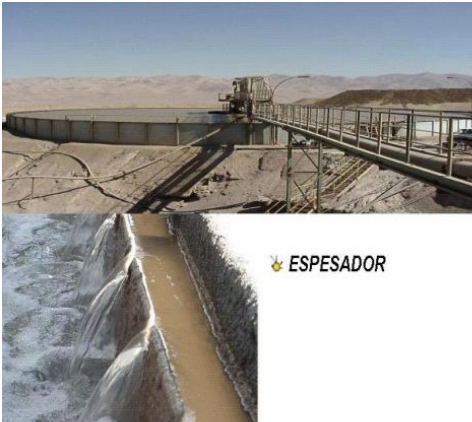
Figura 12 .Espesador de Cono Profundo. Fuente: Manual de Espesador.
