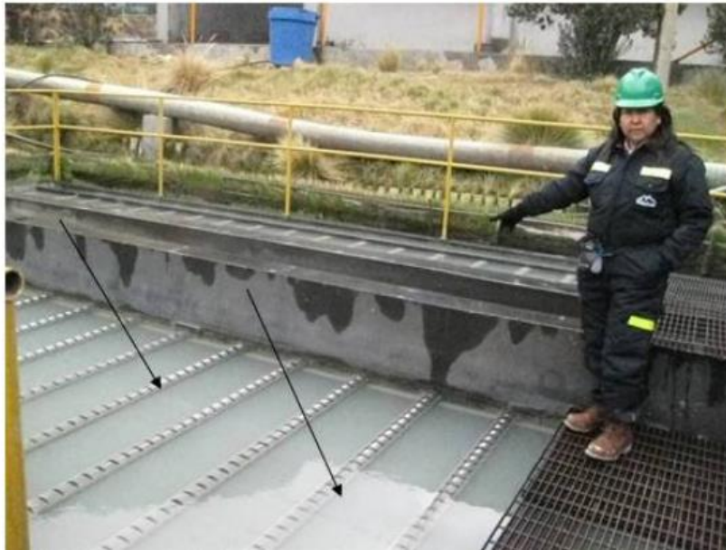
Figura 3. Pozas de placas paralelas, de clarificación
