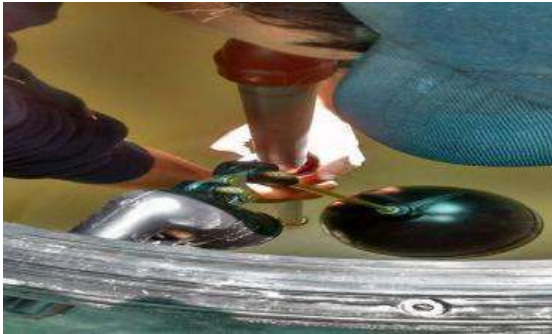
Fotografía N° 8: Válvula check y tuberías.
