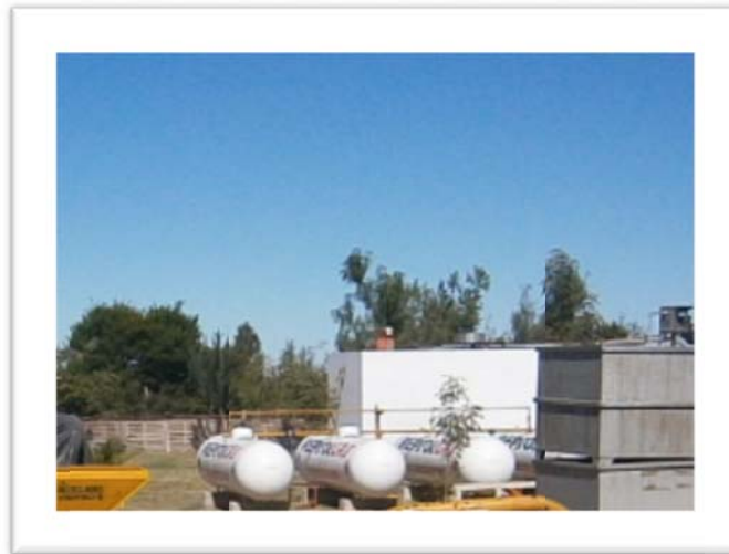
Figura 15: Tanques de Almacenamiento de gas GLP.
