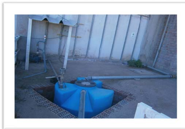
Figura 13: Tanque de almacenamiento de agua de los procesos de Enfriamiento para su recirculación.
