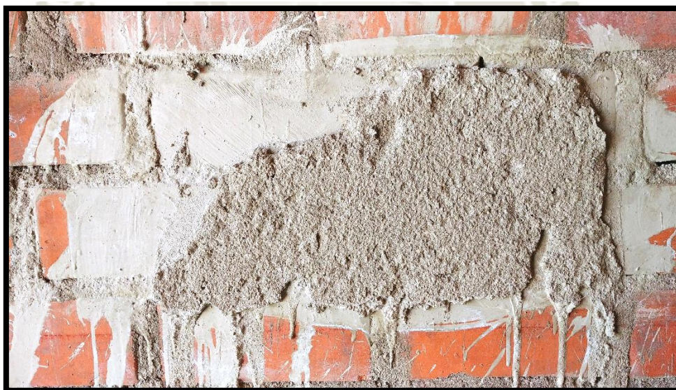
IMAGEN 4.11.- ENSAYO DE ADHESIÓN VERTICAL: ZÓCALO DE SILLAR CON MORTERO 03 DURANTE SU EXTRACCIÓN
