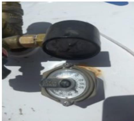
Medición del consumo de GLP de los 6 balones con el medidor de porcentajes, cada uno con capacidad de almacenamiento de 1000 galones
