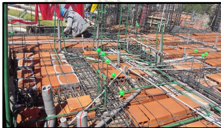
Figura 42: Fotografía instalaciones sanitarias y eléctricas
