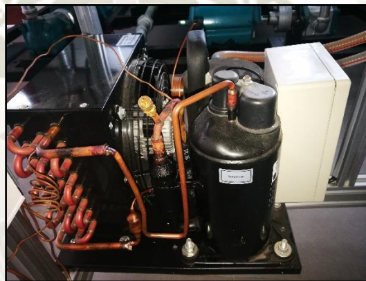
Figura 1: Compresor del sistema de refrigeración.
