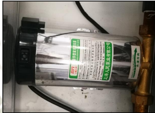
Figura 2: Bomba de agua helada
