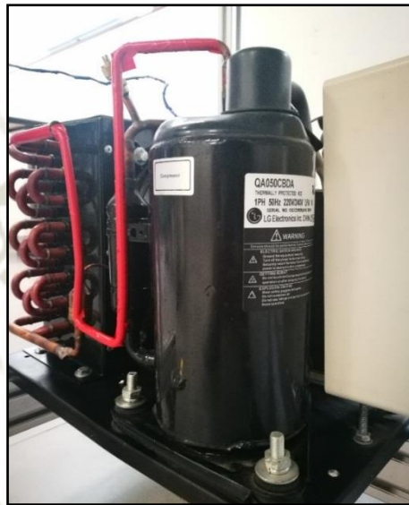
Figura 62: Compresor del equipo de refrigeración Chiller.
