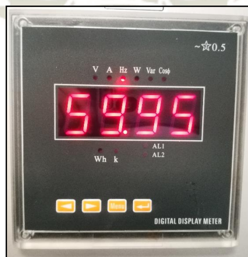
Figura 75: Tablero multifuncional digital.
