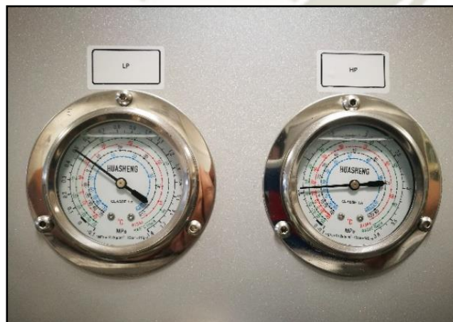
Figura 90: Manómetros de alta y baja del sistema de enfriamiento.
