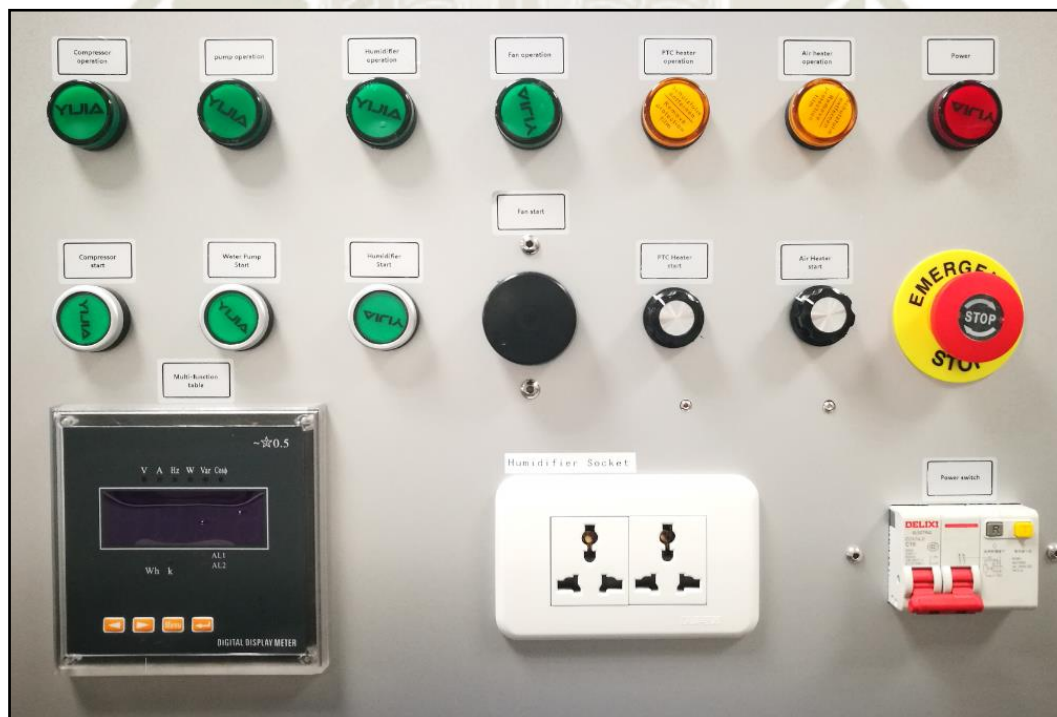
Figura 86: Tablero de control del módulo de aire acondicionado.
