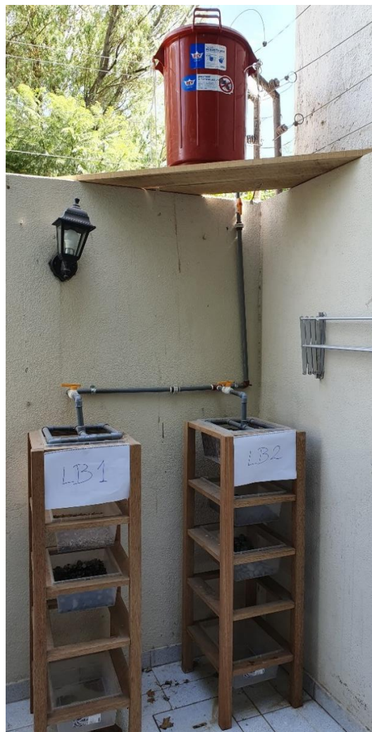
Figura 7: Sistema de tratamiento completo
