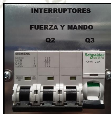
Figura 3.10 Interruptor automático de fuerza y mando
