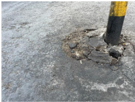
Foto 33: Desgaste de la superficie de rodadura
