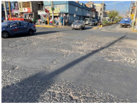
Foto 31: Desgaste de la superficie de rodadura
