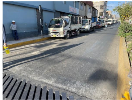
Foto 22: Desgaste de la señalización horizontal
