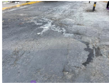
Foto 34: Estancamiento de agua en la superficie de rodadura
