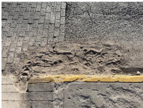
Foto 35: Material suelto en la superficie de rodadura
