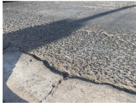
Foto 32: Desgaste de la superficie de rodadura
