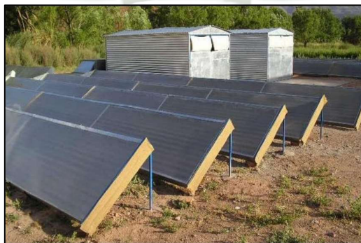
Figura 9 Colectores y cámaras de secado
