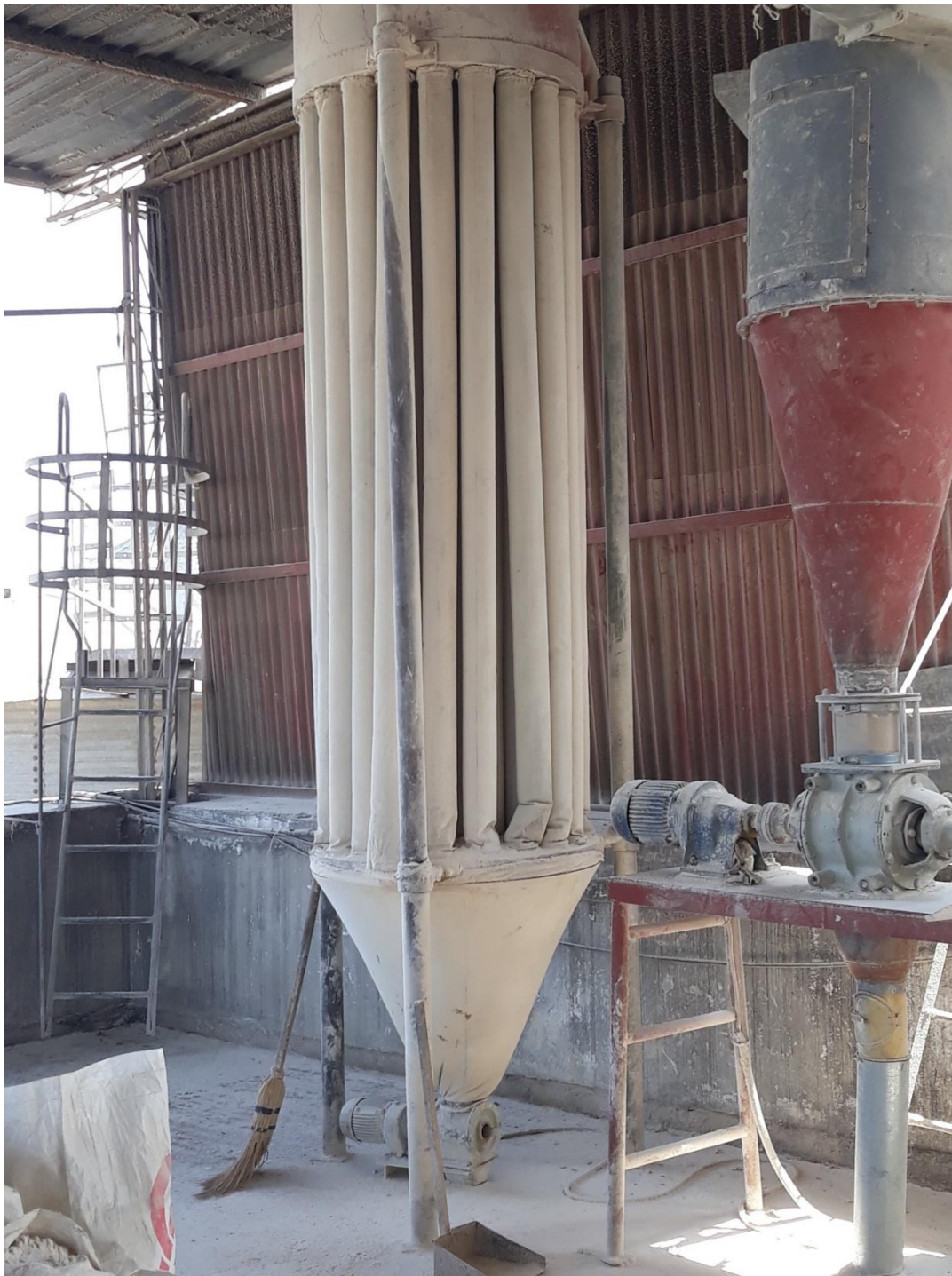
Figura N° 28: Filtros de mangas actuales del molino Las Mercedes
