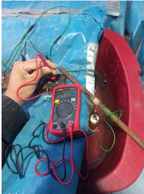
Figura 78 Ánodo de sacrificio medición de potencial 24 horas después
