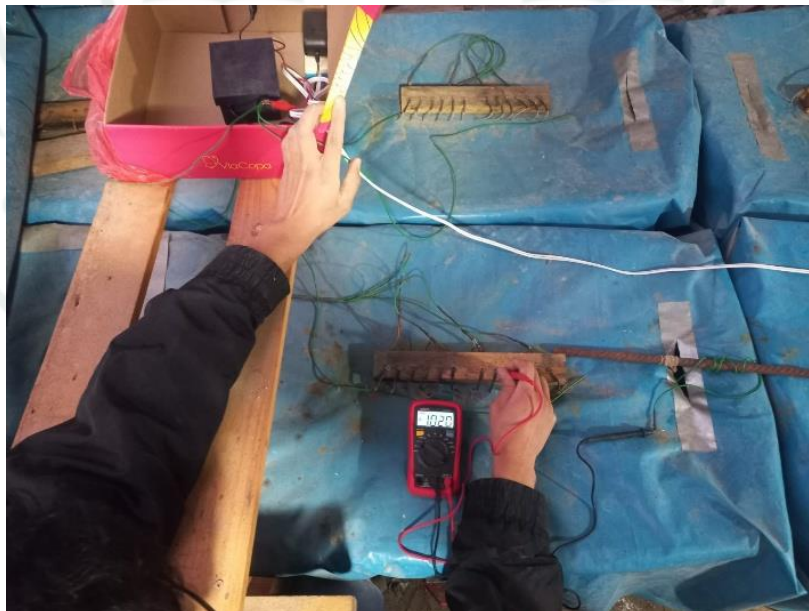
Figura 79 Medición del potencial ON en el sistema de protección catódica por corriente impresa
