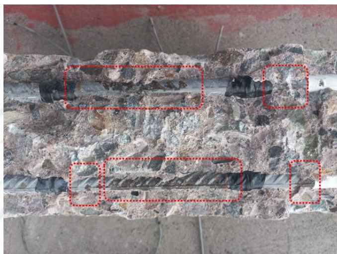
Figura 87 Efectos de sobreprotección sometida a protección catódica con 50mA y 15V, pequeños puntos de corrosión localizados
