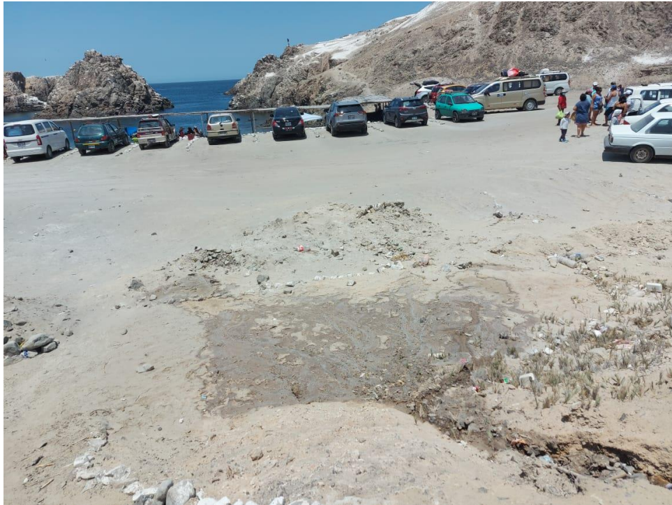
Filtración de aguas residuales
