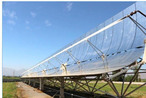
Concentrador Solar Tipo Cilindro Parabólico
