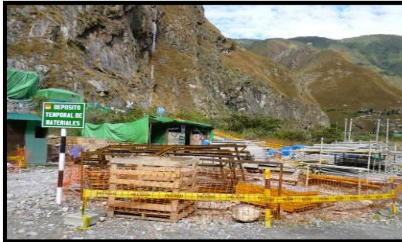
Figura 36 - Delimitación de áreas de almacenamiento
