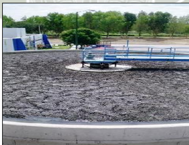
Figura 1.18 Espesador de lodos por gravedad
