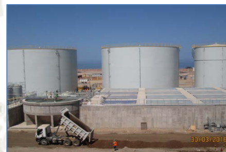
Tanque de Almacenamiento Combustible Diésel B5
