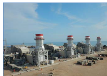
Turbinas y Generadores 1, 2, 3 y 4
