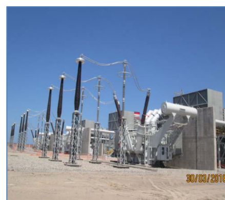
Transformadores de la C.T. Puerto Bravo
