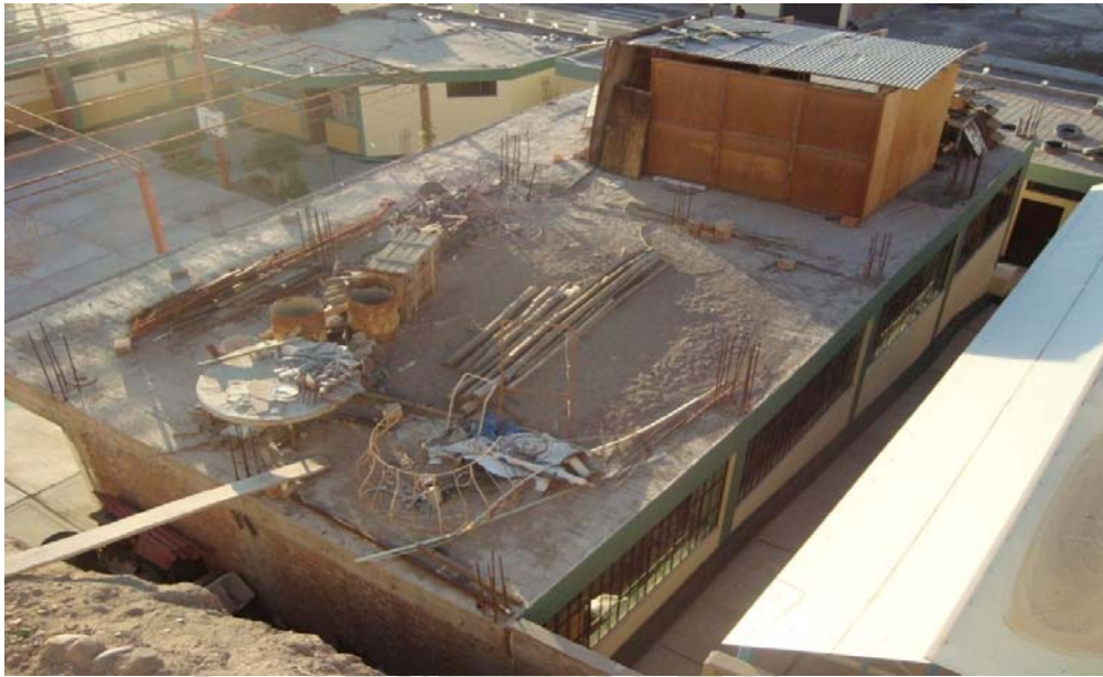
ILUSTRACION N° 21. Se puede apreciar la falta de mantenimiento de los techos del colegio.
