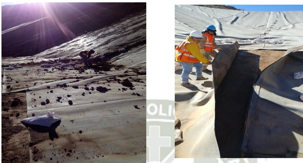
Foto 87: Zonas dañadas para reparación - Quellaveco
