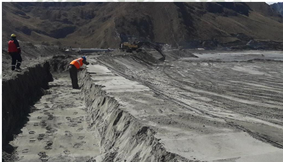
Foto 98: Cresta en zanja de anclaje se desmorona - Antamina
