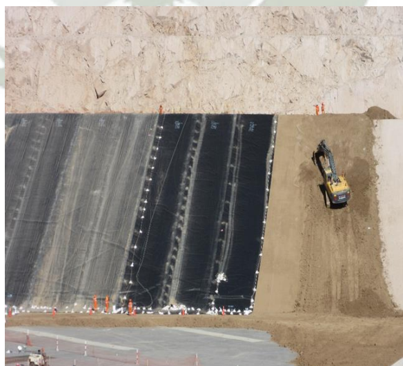
Foto 61: Evidencia de riesgo por interacción de personal y equipos muy cercanos - Quellaveco
