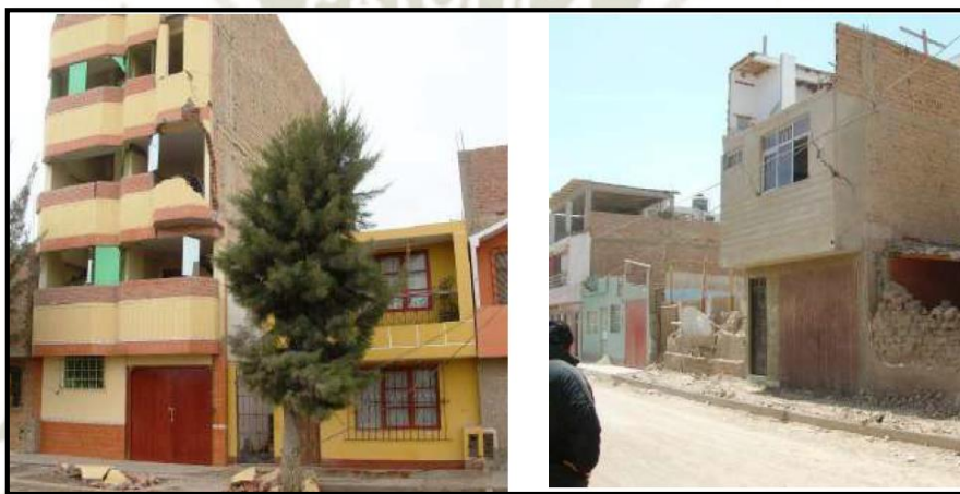
Figura 17: Daños en tabiques de fachada en voladizo, terremoto Pisco, 2007.
