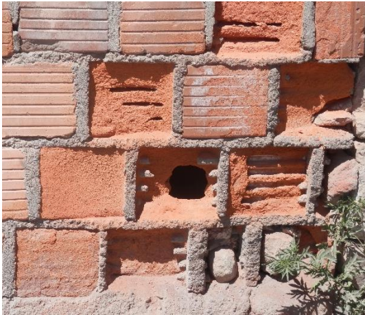
Fotografía 17: Muro de albañilería deteriorada.
