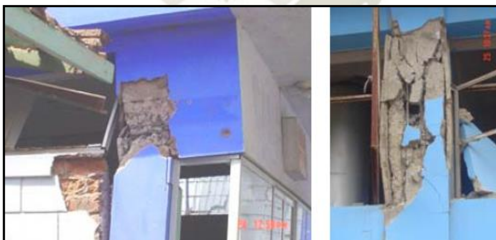
Figura 20: Efecto columna corta. Hospital de Ica
