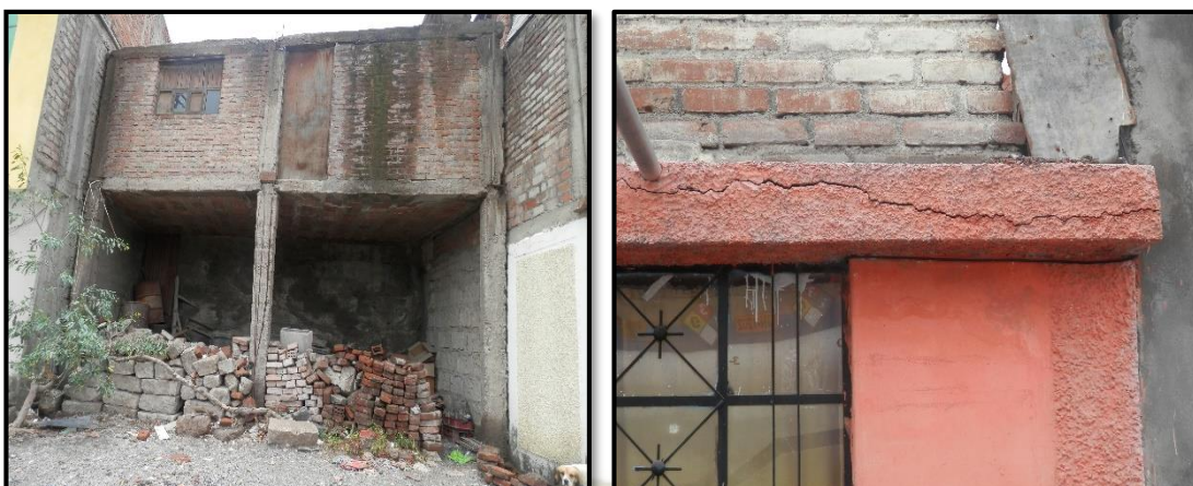
Figura 42: Evidente mal estado de conservación.
