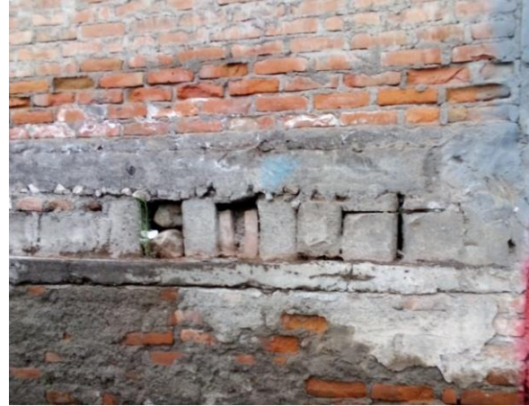
Fotografía 18: Unidades de albañilería mal colocados.
