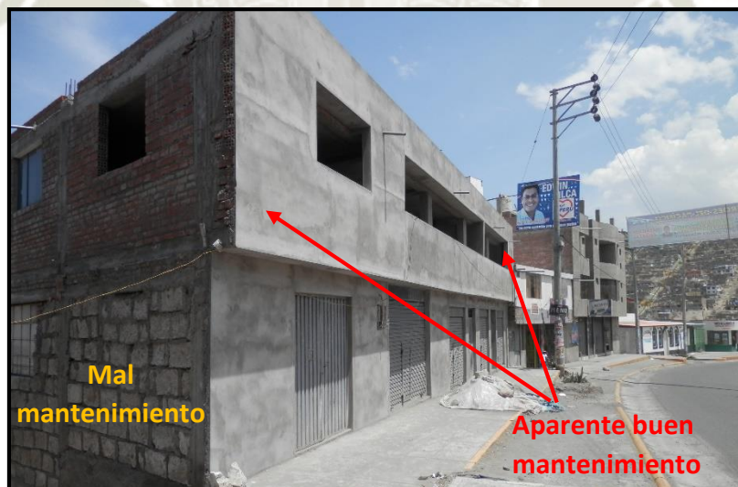
Figura 41: Se aprecia una edificación que tiene una buena apariencia, buen acabado y en el otro lado un mal mantenimiento.
