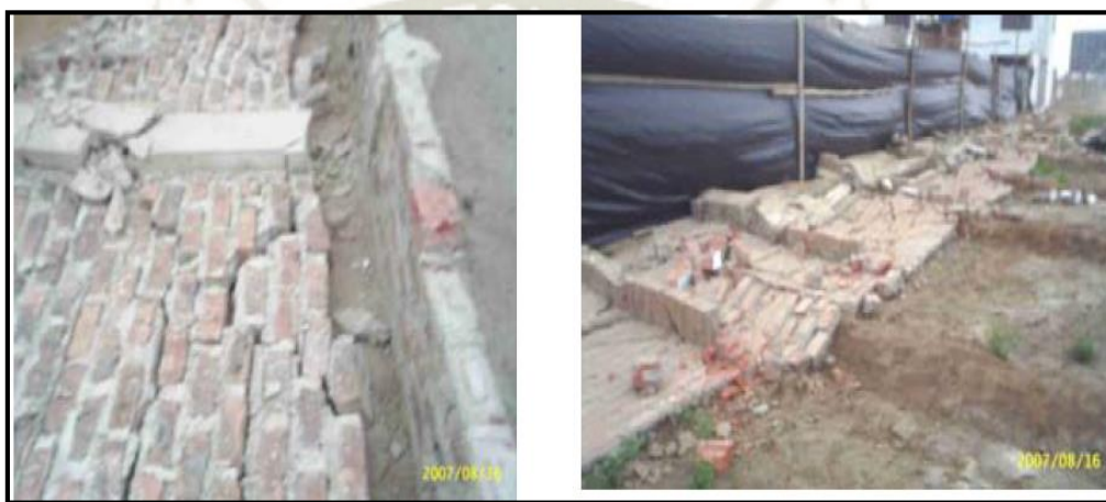
Figura 21: Cercos sin refuerzo que se voltearon. Terremoto Pisco, 2007.
