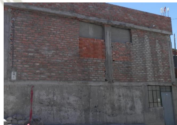
Fotografía 10: Columna corta en el segundo nivel.
