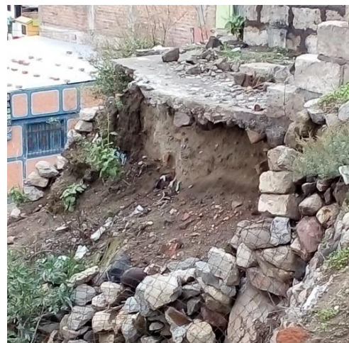
Fotografía 24: Empuje del terreno. Zona 3 del estudio.
