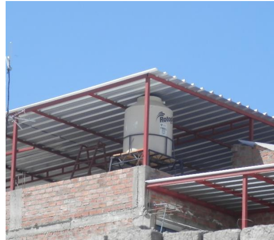
Fotografía 12: Tanque de agua de 1m 3 ubicado en la azotea.
