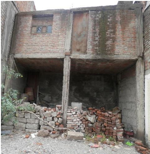
Fotografía 5: Vivienda en estado de ruina.
