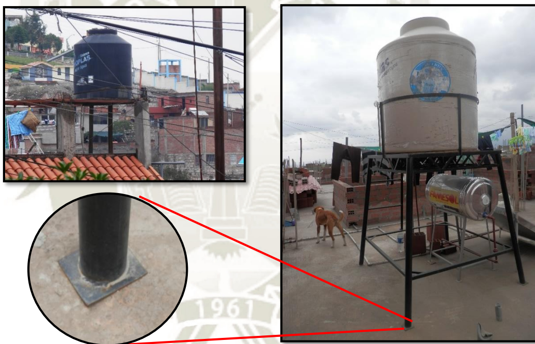
Figura 49: Predisposición al daño de los tanques elevados.
