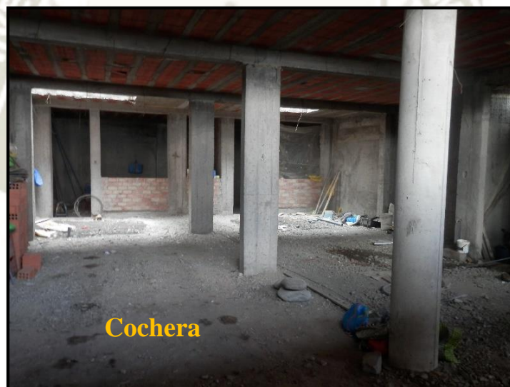
Figura 47: Edificio con Piso blando.
