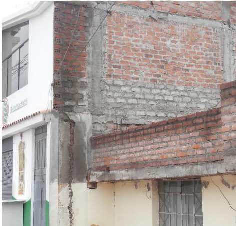
Fotografía 7: Vivienda con muros mixtos, bloquetas con ladrillo.
