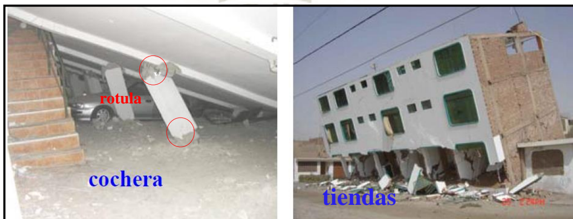
Figura 13: Falla por mecanismo de piso blando, terremoto de Pisco, 2001
