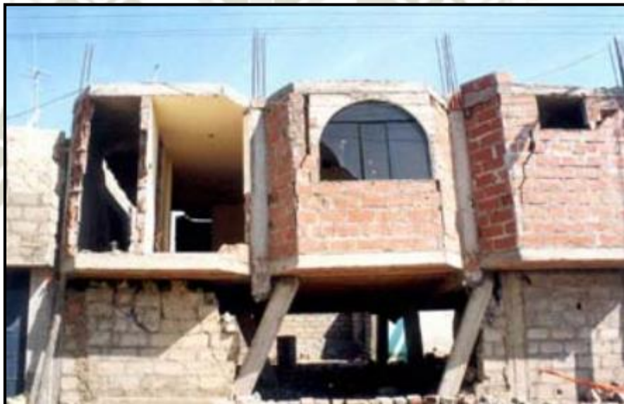
Figura 11: Falla de muros de sillar por mecanismo de piso blando, terremoto de Arequipa, 2001.
