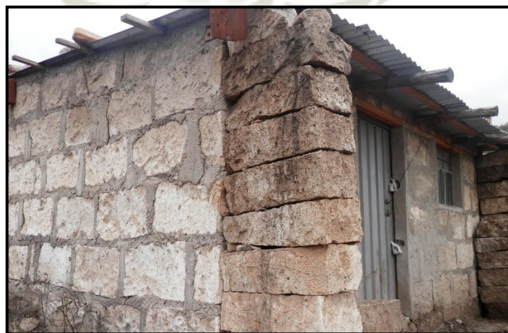
Figura 27: Muros entrelazados de Sillar sin confinamiento con techo de calamina. Fuente: Fotografía propia.
