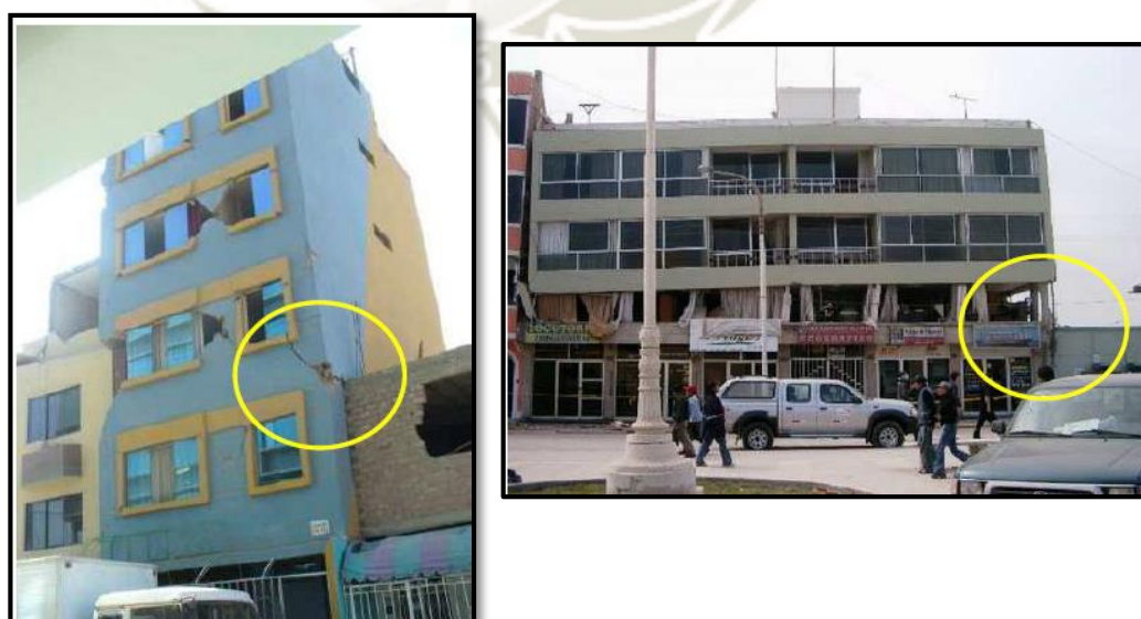
Figura 23: Choque de edificios (efecto golpeteo) terremoto Pisco, 2007.
