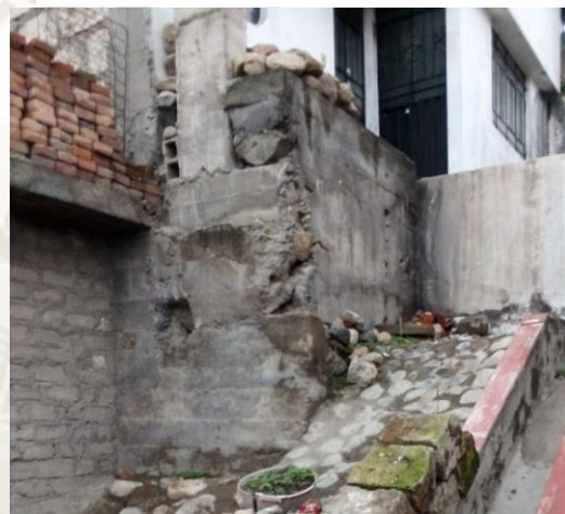
Fotografía 26: Muros de contención de concreto sin refuerzos de acero.
