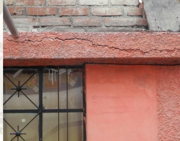
Fotografía 8: Fisuras en el techo de una edificación.
