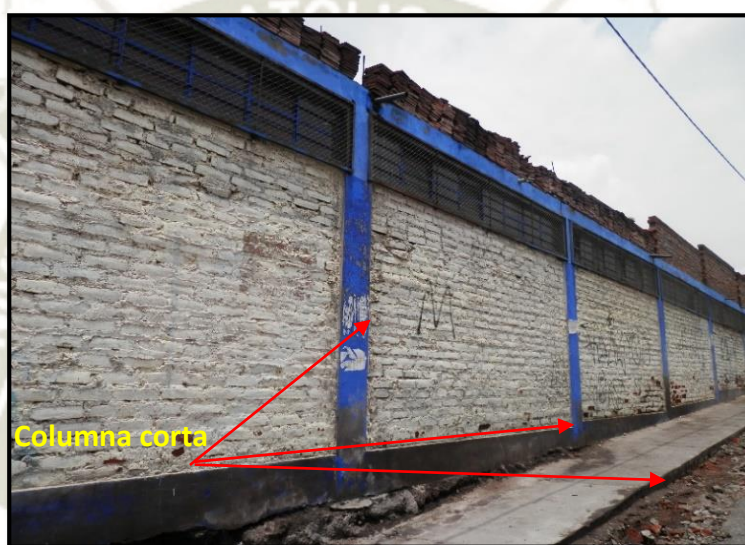
Figura 48: Colegio Julio C. Tello con columnas cortas.
