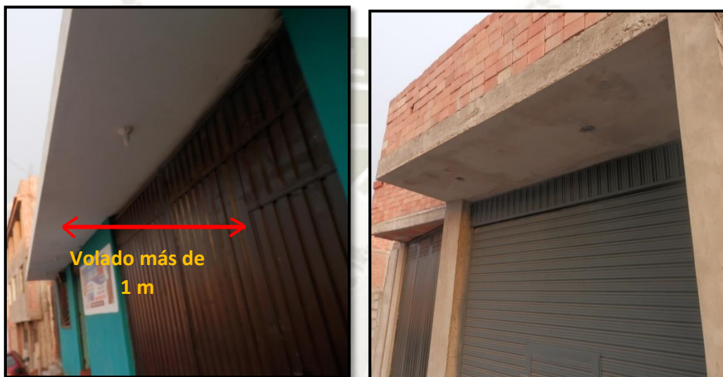
Figura 44: Tabiquería no confinada en voladizos mayores a 80 cm.
