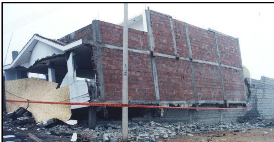
Figura 15: Escasa densidad de muros en la dirección de la fachada. Terremoto Pisco, 2007.
