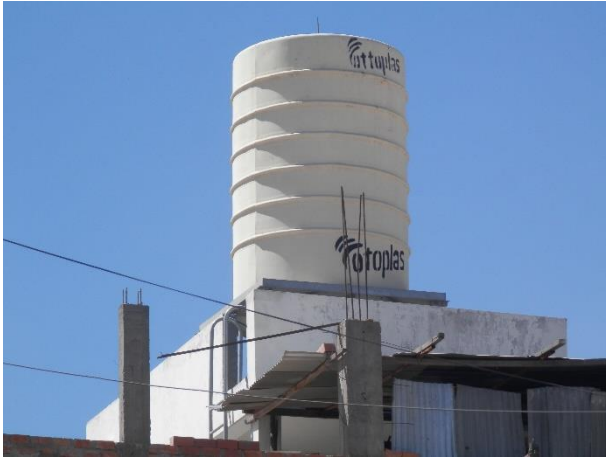
Fotografía 11: Tanque de agua de 10m 3 ubicado en la azotea.
