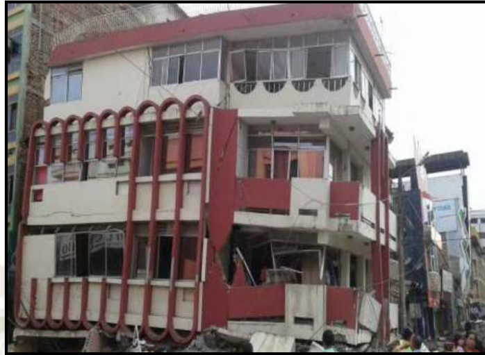
Figura 14: falla de columna del primer nivel por piso blando y falta de confinamiento, el edificio tenía columnas esbeltas en el primer nivel. Terremoto Ecuador, 2016.
