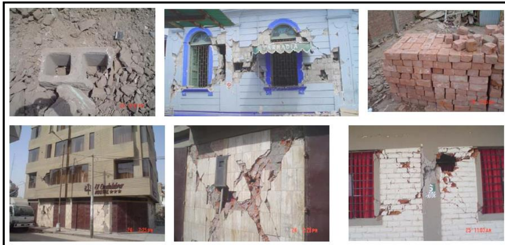
Figura 10: Uso inadecuado de unidades de albañilería, terremoto Pisco e Ica, 2007
