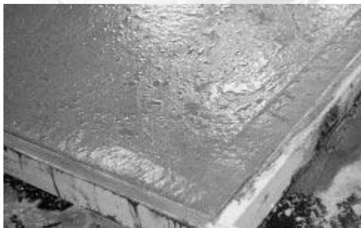
Fig. 1.8: Agua de exudación en la superficie del concreto recién colocado en la losa. Fuente: PORTLAND CEMENT ASSOCIATION (PCA) – 2004.
