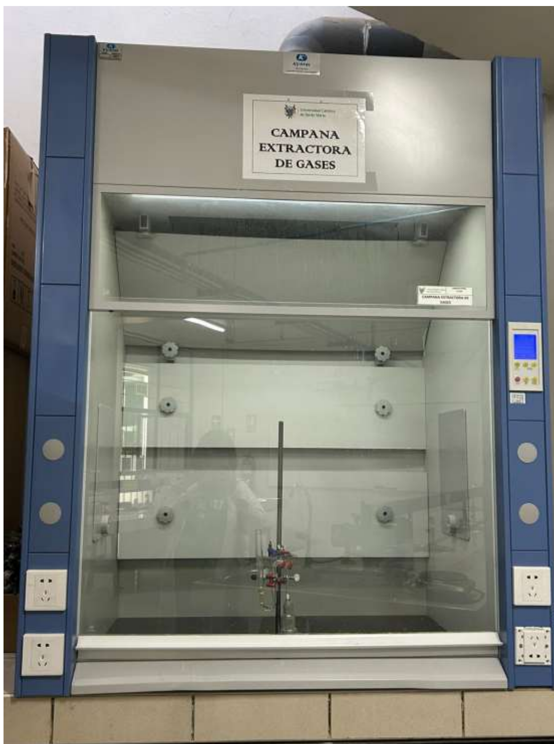
Equipo reaccionando en la campana de extracción.
