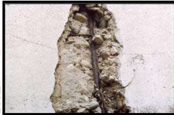
Figura 18: Delaminación del concreto por corrosión del acero
