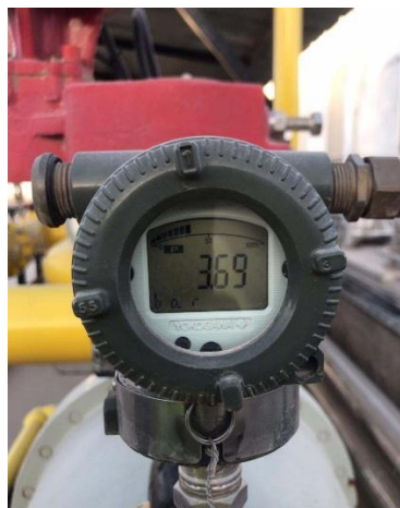
Figura 15. Transmisor inteligente de presión (Fuente:propia)
