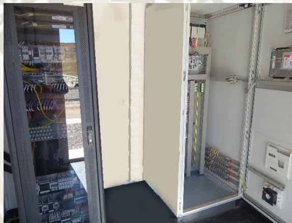
Figura 30. Gabinete de comunicación y gabinete de control. (Fuente: Propia)
