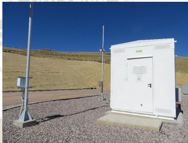
Figura 29 Sala de comunicación y de automatización. (FUENTE: PROPIA)
