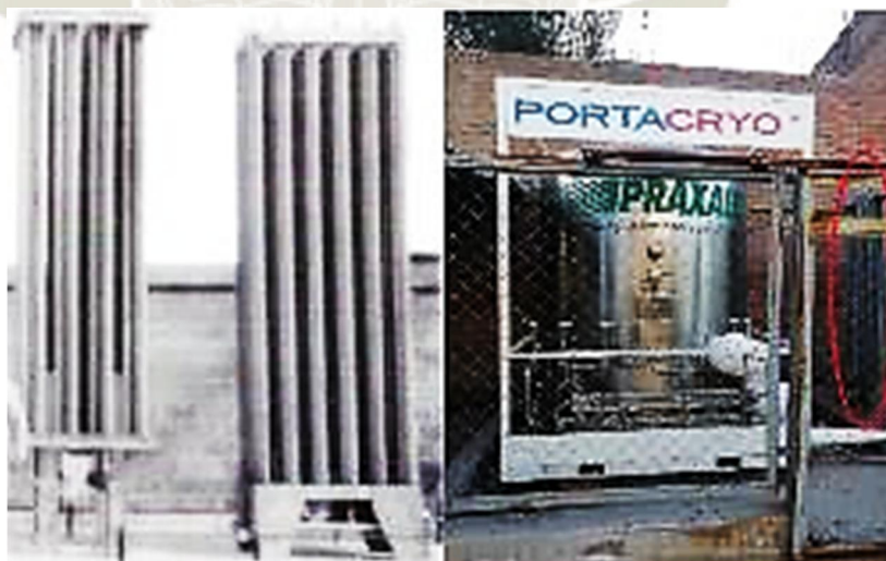
Foto 04 Evaporador ambiental, que transforma el oxígeno líquido a oxígeno gaseoso
