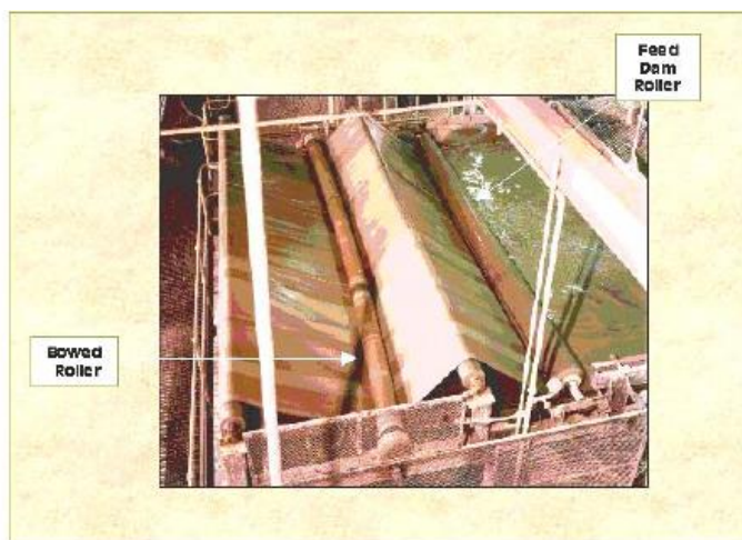
Fig. 2.39 Rodillo curvo en operación en extremo de la polea de cola del filtro
