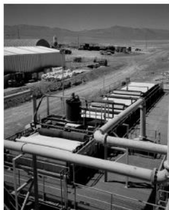
Filtros de banda horizontal de 54 m 2 cada uno en la Planta El Peñón de Minera Meridian.
