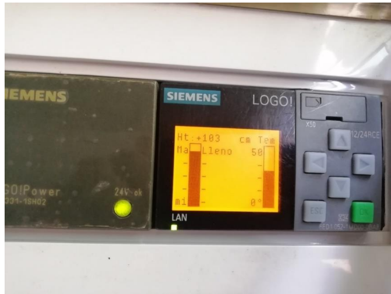
Figura 52. Pantalla principal de control de nivel de agua osmonizada.
