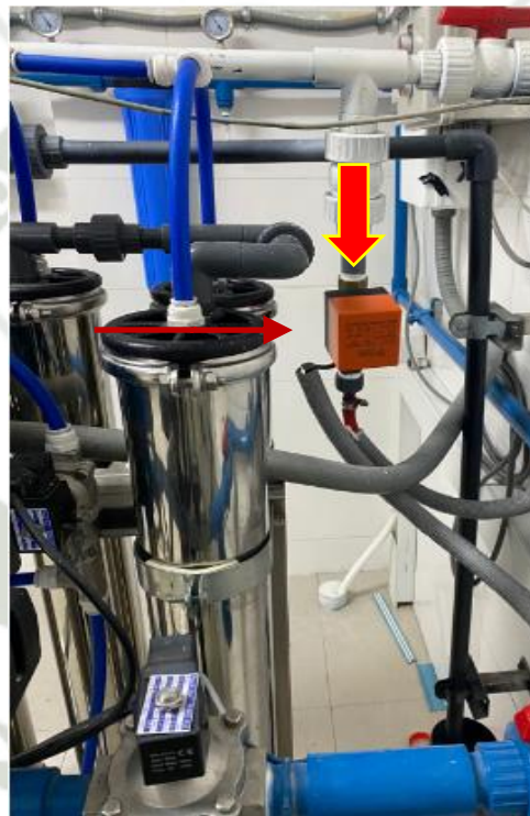
Figura 44. Dirección del flujo de agua osmonizada controlado por la válvula motorizada.
