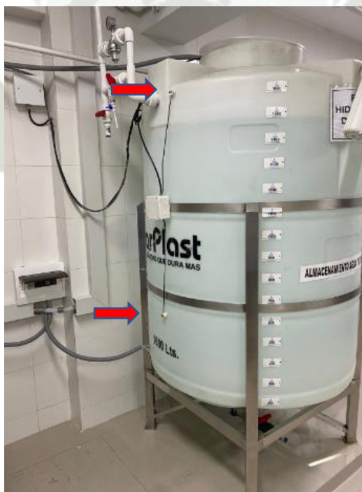
Figura 43 Ubicación de sensores en la parte baja del sistema.
