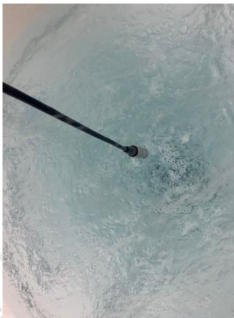
Figura 42. Transmisor de nivel HDL300 dentro del tanque de agua osmonizada.
