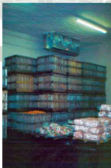
FIGURA N° 7 ALMACENAMIENTO REFRIGERADO - VISTA INTERIOR DE UNA CÁMARA.
