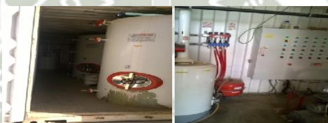
Fotografía N° 2 Interior del Biodigestor HPTC – High Performance Temperature Controlado instalado en el Campus del Fundo La Catolica en Irrigacion Majes – Pedregal.
