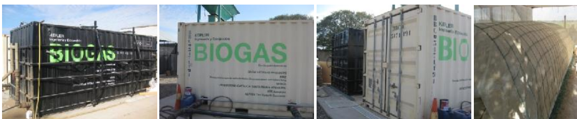
Fotografía N° 1 Biodigestor HPTC – High Performance Temperature Controlado instalado en el Campus del Fundo La Catolica en Irrigacion Majes – Pedregal.
