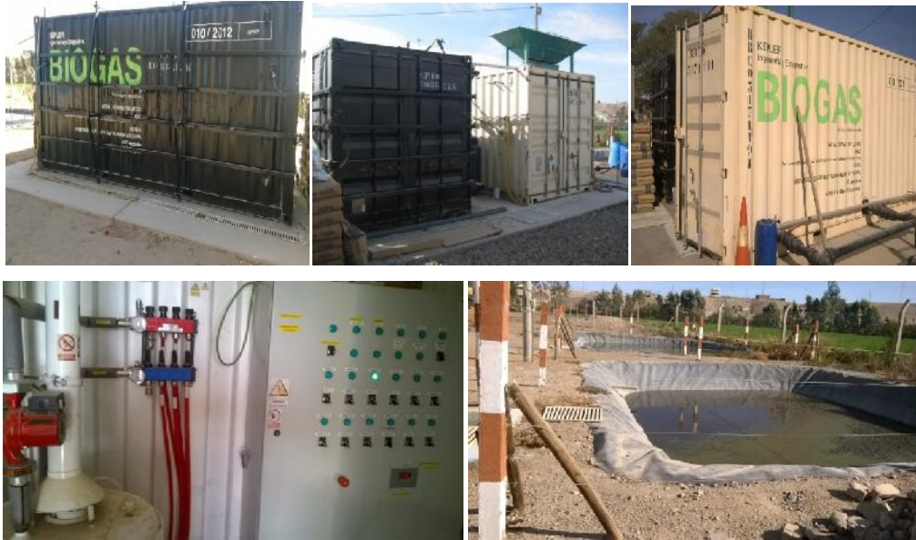
FIGURA N° 05. IMAGENES SUPERIOR IZQUIERDA CONTEINER COLOR NEGRO EN SU INTERIOR CONTIENE BOLSA DEL BIODIGESTOR PROPIAMENTE DICHO. DERECHA SUPERIOR CONTEINER BEIGE CONTIENE EN SU INTERIOR TANQUES DE HIDRÓLISIS, MANDOS, BOMBAS Y CALDERO. AL CENTRO UBICACIÓN DE LOS CONTEINER, UNO AL COSTADO DEL OTRO. ABAJO IZQUIERDA MANDOS AUTOMATIZADOS PARA BOMBEO PROGRAMADO Y CALDERO. ABAJO DERECHA ESTANQUE CON GEOMEMBRANA PARA RECEPCIONAR EL BIOL.
