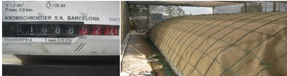
FIGURA N° 07. A LA IZQUIERDA CONTADOR DE GAS MODELO GCZ BK-G4M MARCA KROMS CHROEDER DE FABRICACIÓN EN BARCELONA – ESPAÑA. A LA DERECHA GASÓMETRO CON CAPACIDAD DE 60 M3.
