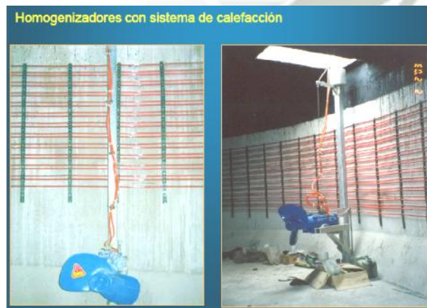
Figura17. Biodigestor, interior con sistema de calefacción y homogenizadores.
