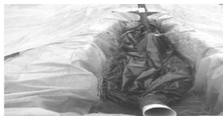
FOTOGRAFIA 11 UBICACIÓN CORRECTA DE LA TUBERÍA DE SALIDA DEL BIODIGESTOR.
