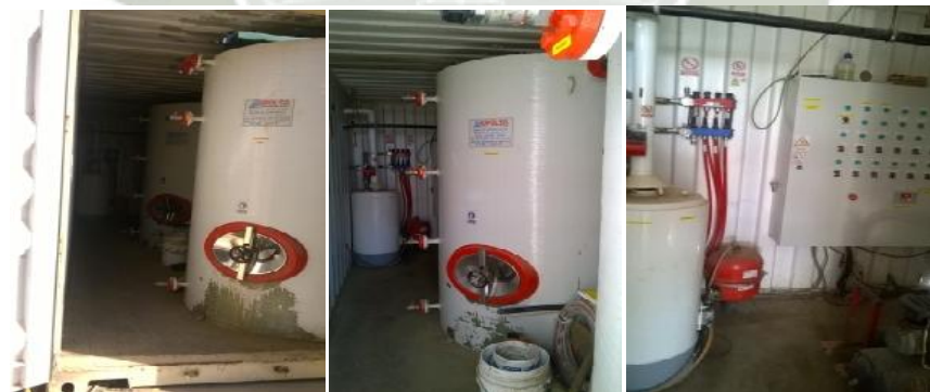
FIGURA N° 06. IMÁGENES A LA IZQUIERDA DENTRO DEL CONTEINER BEIGE SE MUESTRAN LOS DOS TANQUES DE HIDRÓLISIS; AL CENTRO SE MUESTRA EN PRIMER PLANO EL SEGUNDO TANQUE DE HIDROLISIS Y AL FONDO EL CALDERO DE AGUA. A LA DERECHA EL TABLERO DE MANDO, EN EL PISO BOMBA Y AL COSTADO EL CALDERO DE AGUA.
