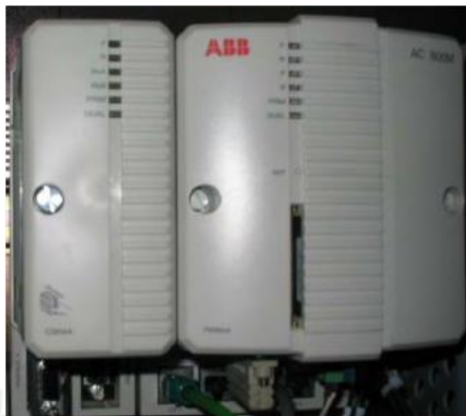
Figura 3-57: Controlador AC800 con Módulos de interfaz de Profibus DP-V1
