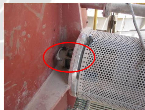
Fig. 2 Caja de Empaquetaduras del lado reductor.
