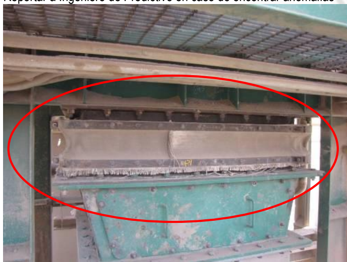
Fig.4 Junta del ducto de salida de la rueda celular.
