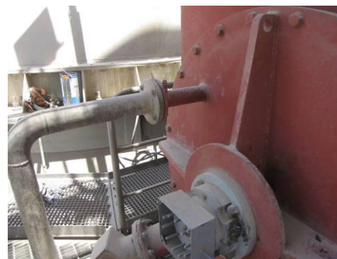
Fig. 3 Tubería de Aire de Sello
