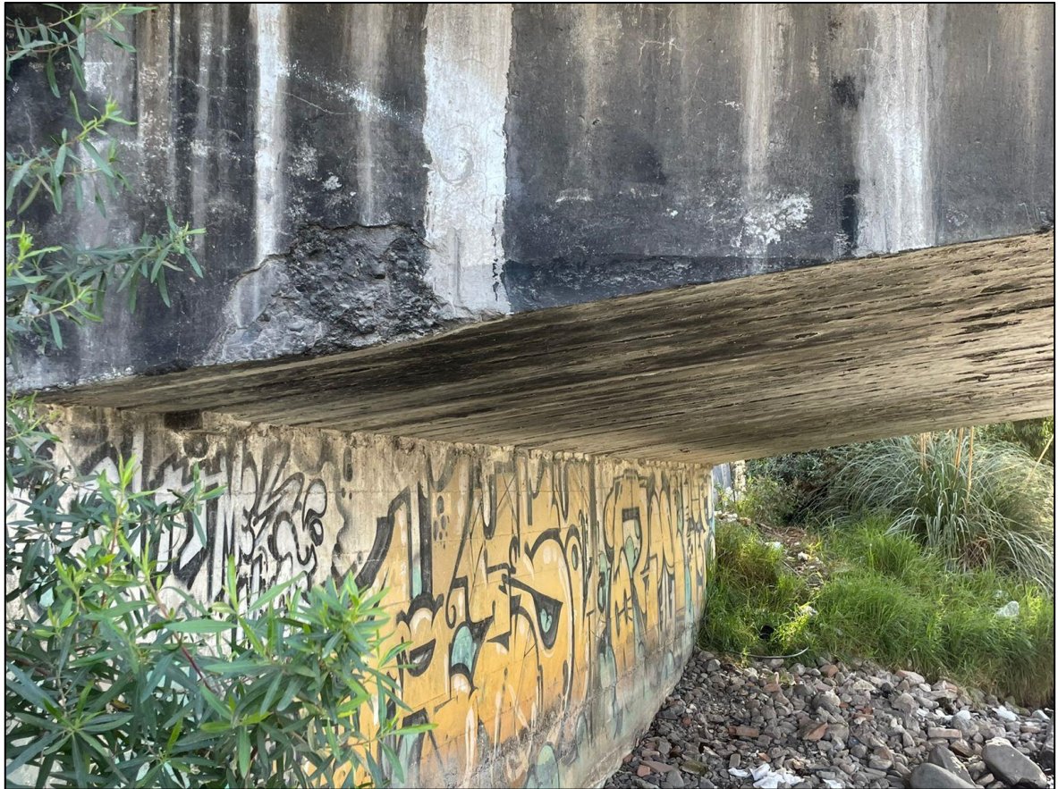
Figura 3.5 Erosión en la parte lateral e inferior del tablero del puente San Martín
