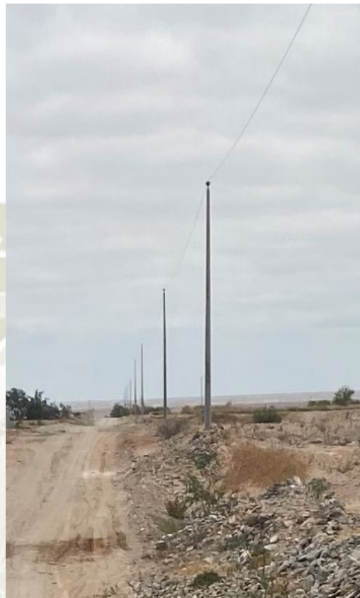
Figura N° 3.1-5. 1706 m. de Red Monofásica
