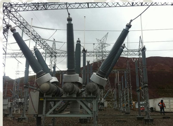
Figura N° 2.4-1. Interruptor de Potencia en Alta Tensión.
