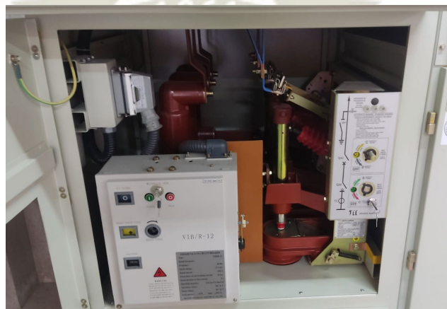
Figura N° 2.4-2. Interruptor de Potencia en Media Tensión.
