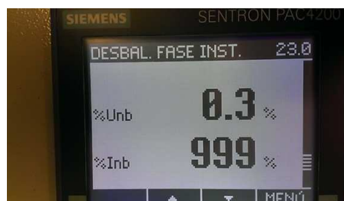
Desbalance de cargas del circuito
