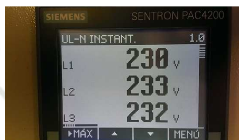
Tension entre líneas y neutro
