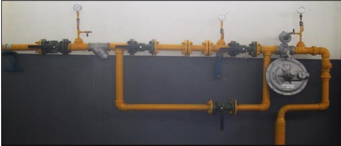
Figura 16. Estación de regulación de presión secundaria.
