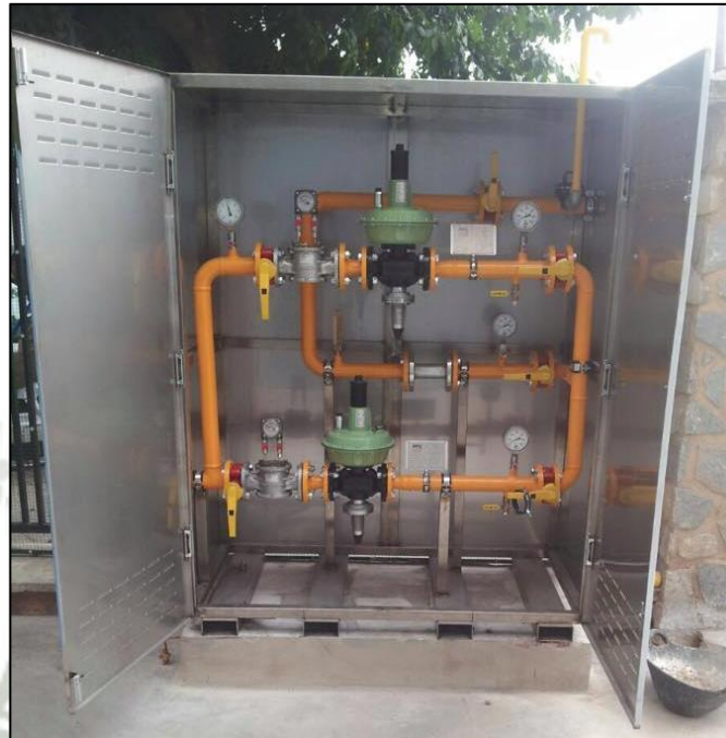
Figura 9. Estación de regulación de presión y medición primaria de gas natural en un recinto metálico
