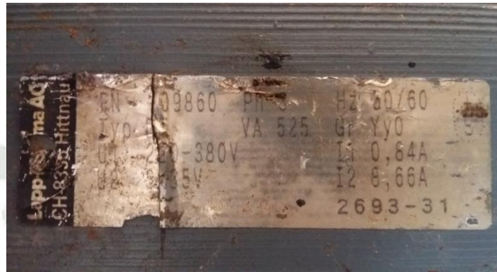
Figura 4.1.2.1.1 Datos de placa del transformador trifásico de prueba
