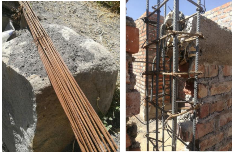
Figura 35 Acero de refuerzo longitudinal corroído usado en la construcción de columnas S-01 (Izquierda); Estribos de acero usados en el confinamiento de columna con indicios de corrosión SC-02 (Derecha)
