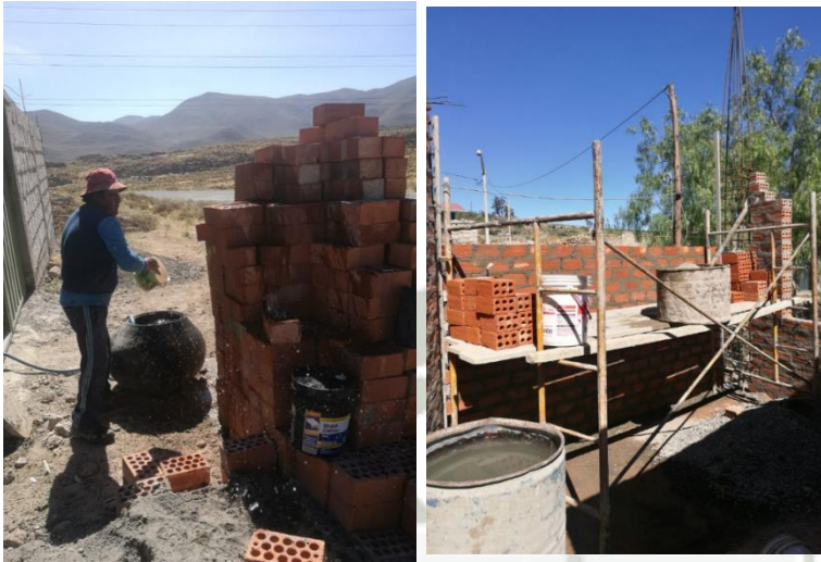
Figura 46 Peón regando ladrillos inadecuadamente, justo antes de asentarlos SC-03 (Izquierda); Plataforma de asentado se puede observar un balde que sirve para remojar los ladrillos antes de asentarlos S-01 (Derecha)
