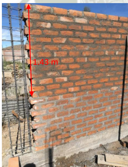
Figura 42 Muro de ladrillo asentado en una jornada mayor a 1.30 m de altura, las unidades de albañilería son sólidas macizas lo cual exige según norma que el asentamiento de la primera jornada debe concluir con la última hilada no llenada en juntas verticales.
