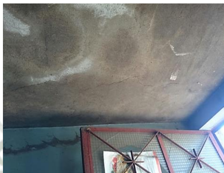
Figura 150 Grieta en losa de vivienda SA-03
