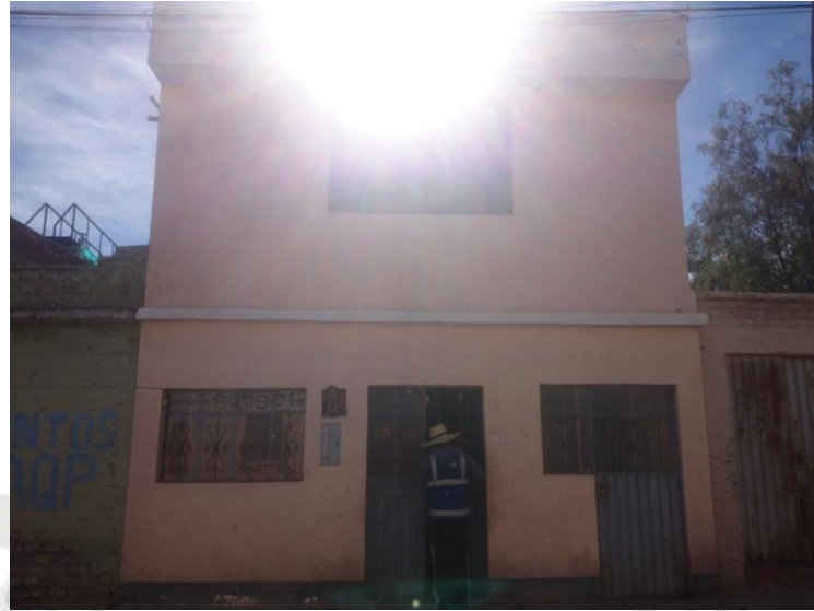
Figura 166 Vivienda que no cuenta con separación sísmica con viviendas adyacentes, Y-11
