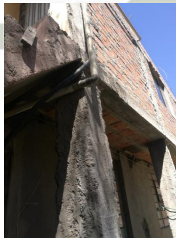
Figura 147 Presencia de cangrejas en columna de vivienda Y-11
