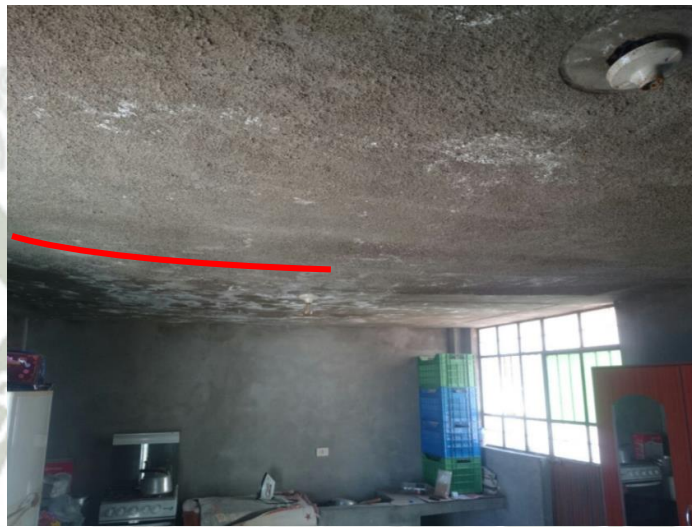
Figura 152 Deflexión de losa apreciable en vivienda SA-04
