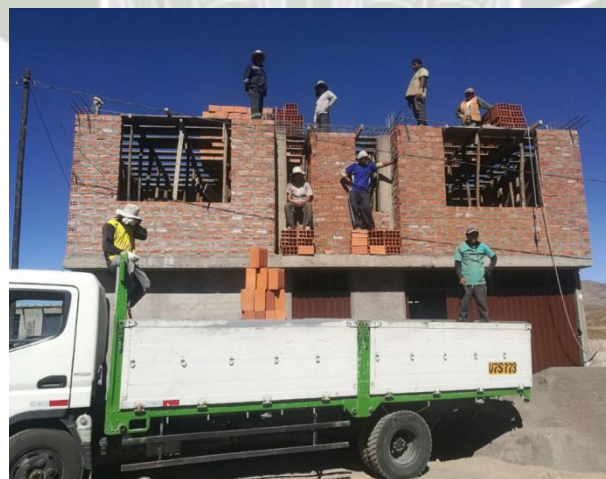
Figura 75 No se identifica ningún tipo de señalización ni cerco perimetral SA-02
