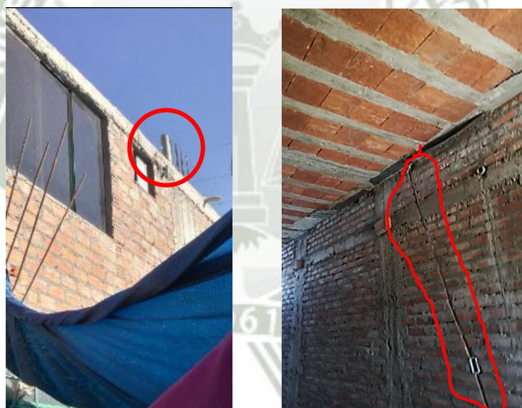
Figura 157 Columna ubicada en columna, la cual sirve como elemento de confinamiento en un muro portante. (SC-08) y (LM-03)
