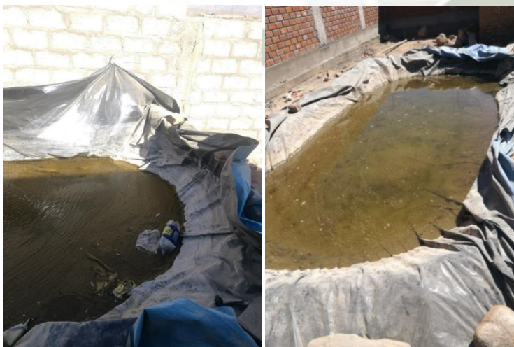
Figura 33 Pozos Improvisados de Agua usada en la Preparación del Concreto y Mortero almacenada más de dos días; se observa materia orgánica como algas y restos de basura en las construcciones S-01 y SA-02
