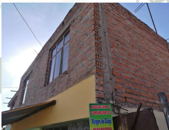
Figura 128 Vivienda construida con mas pisos de los que se proyectó.
