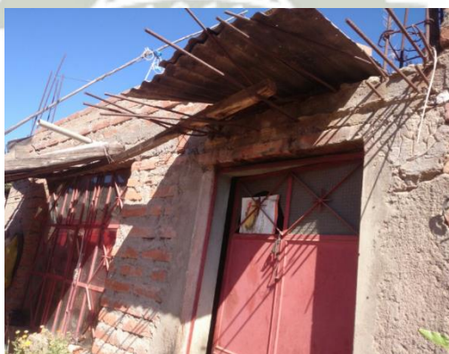
Figura 151 Pestañas de acero expuesto en losa de vivienda SA-03.
