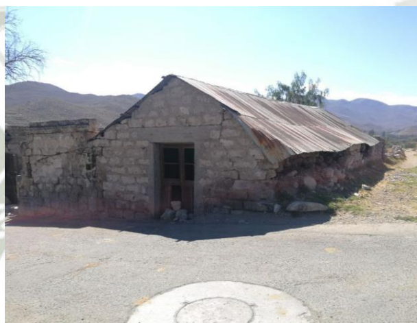
Figura 7 Vivienda afectada por el terremoto del 2001.
