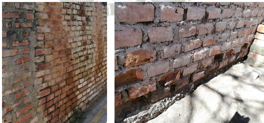
Figura 143 Muros con deterioro alto en viviendas Y-12 y Y-02
