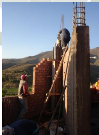
Figura 77 Escalera apenas apoyada en muro no cuenta con ningún tipo de amarre seguro en su base o en la parte superior S-01
