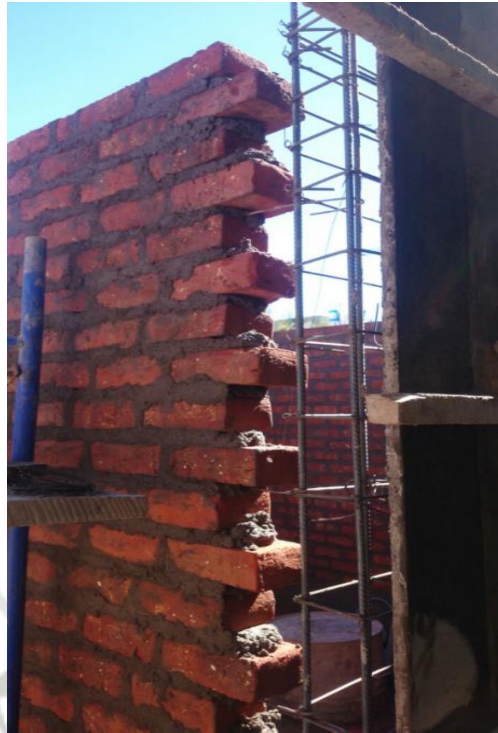
Figura 44 Muro con excesiva longitud en ladrillos de amarre con columna SC-01
