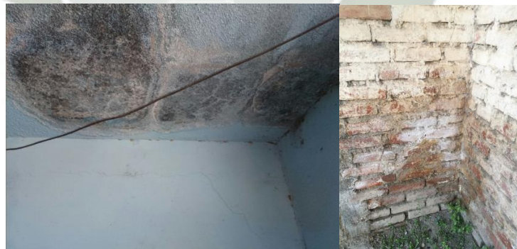
Figura 170 Humedad en losa de vivienda (SA-01)
