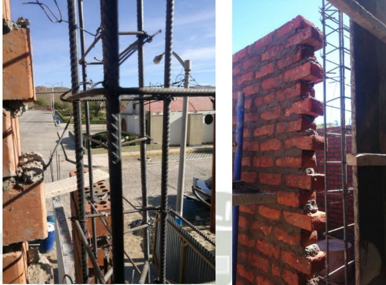
Figura 71 Incorrecta colocación de estribos SA-01 (Izquierda) y SC-01 (Derecha)
