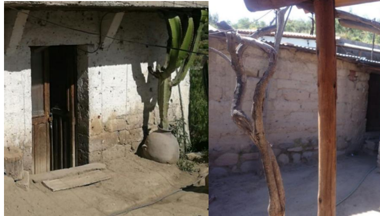
Figura 177 Vivienda con evidente afectación de la humedad en la zona baja de sus muros de sillar (S-04) (Izquierda); A manera de sobrecimiento una consecución de piedras con mortero protegen al muro de adobe (Derecha)
