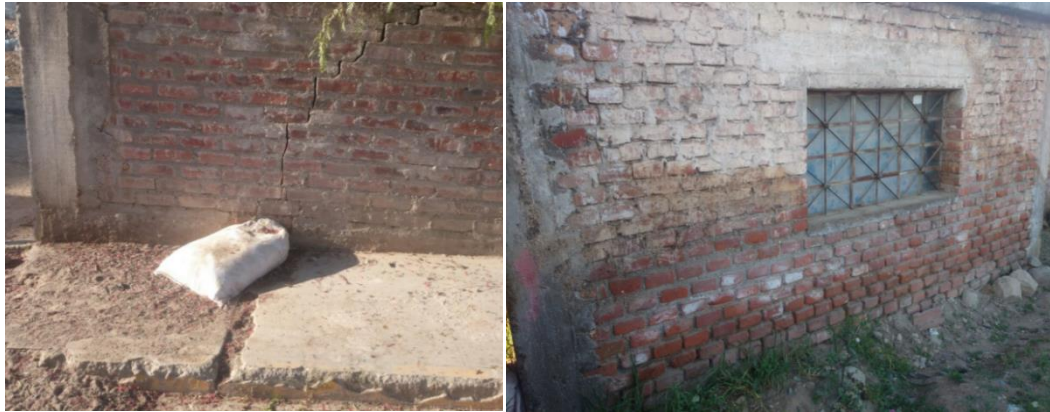
Figura 155 Muro en donde se aprecia falla a través de la junta, lo que describe una pésima calidad del mortero SA-014 (Izquierda); Junta en muro en pésimo desgastado y con gran aparte ya desmoronada (SA-17) (Derecha)
