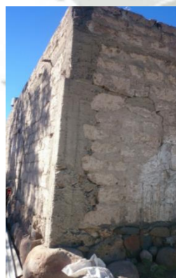
Figura 133 Fisura en muro y columna de confinamiento, Vivienda CH-01
