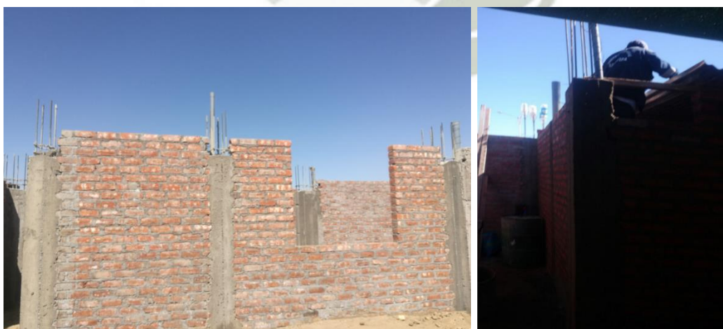
Figura 50 Columna alojando una tubería de desagüe \Phi=4" SC-02 (Izquierda); Columna ubicada fuera de la sección de refuerzo de la columna, pero en la zona de amarre entre esta y el muro SC-01 (Derecha)
