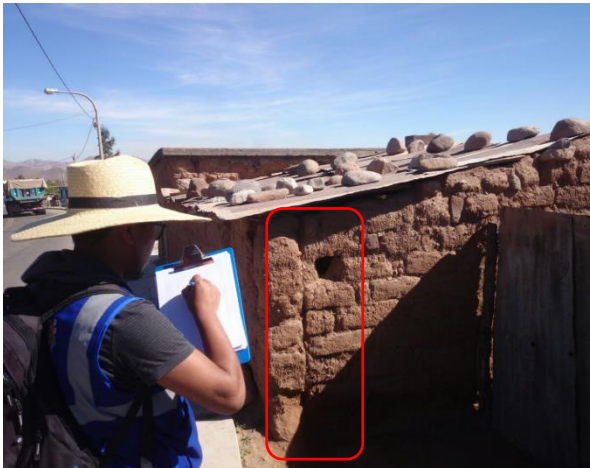
Figura 172 Vivienda SA-02, se identifica la falta de conexión de muros ortogonales.
