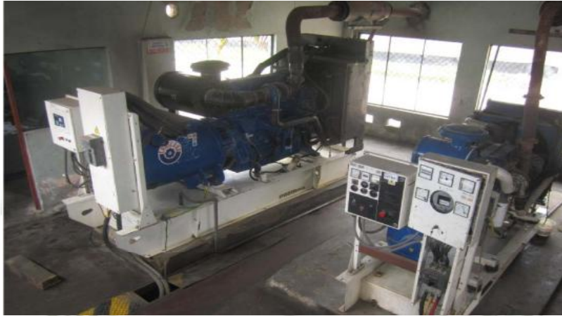
Figura 12. Sistema eléctrico aislado tipo térmico- Ático 550 kW, SEAL
