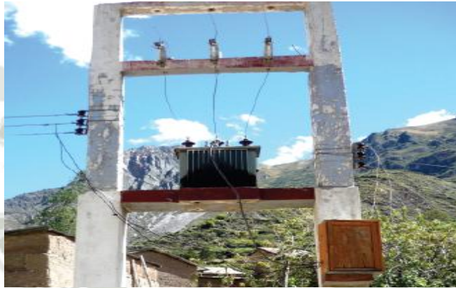
Figura 10. Subestación de distribución aérea
