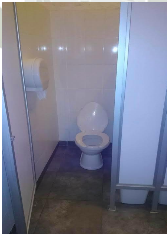
Fig. 23. Servicios higiénicos inaccesibles de la Mansion del Fundador, no permiten ingreso ni desplazamiento en sillas de ruedas.
