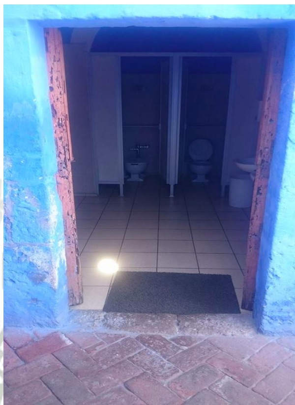
Fig. 11. Imágen de los servicios higiénicos de uso para los visitantes del Monasterio de Santa Catalina, donde se aprecia que no son accesibles
