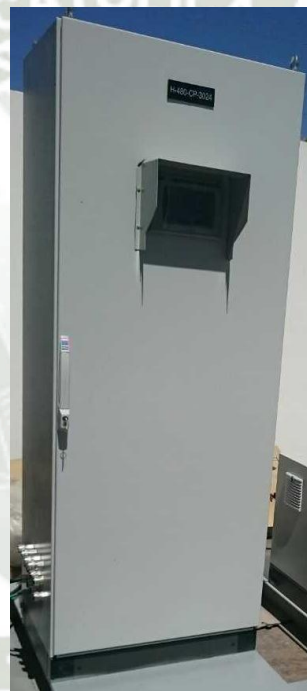
Fig. 2-2 Tablero de control.
