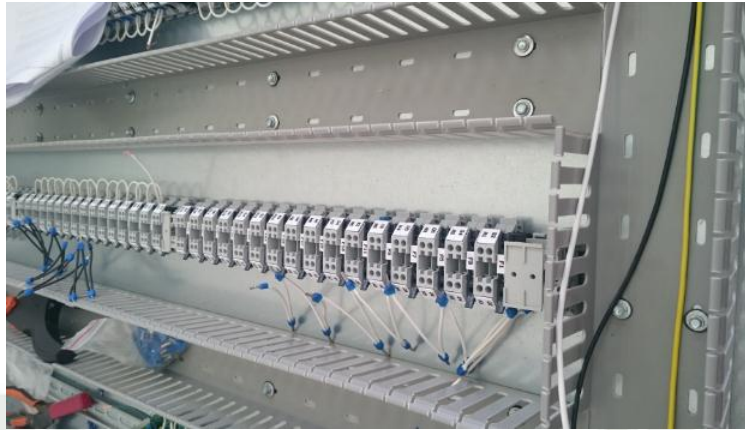
Fig. 3-60 Back panel de tablero de control
