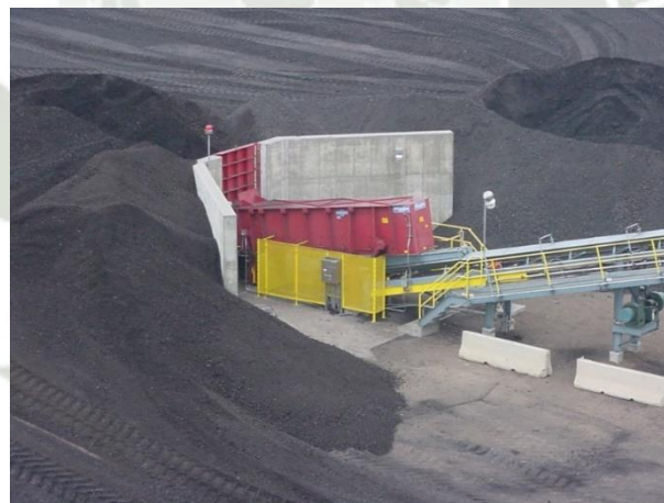
Alimentador de arrastre y recuperación
