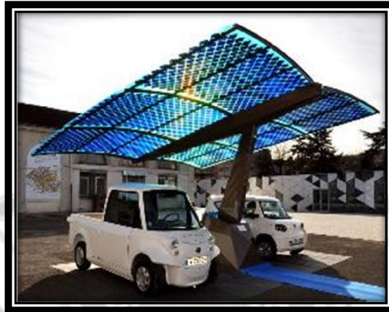
Figura Nº 7: Estación de recarga con Paneles Solares
