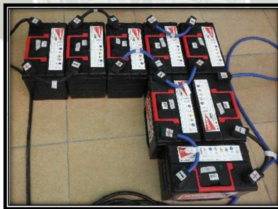
Figura Nº 39: Banco de baterías Fuente: Elaboración propia
