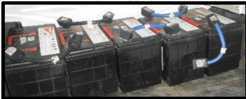
Figura N° 51: Baterías posterior Fuente: Elaboración propia
