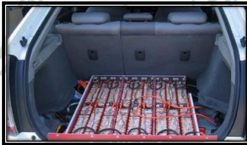
Figura Nº 8: Banco de baterías Fuente: https://actualidad.rt.com
