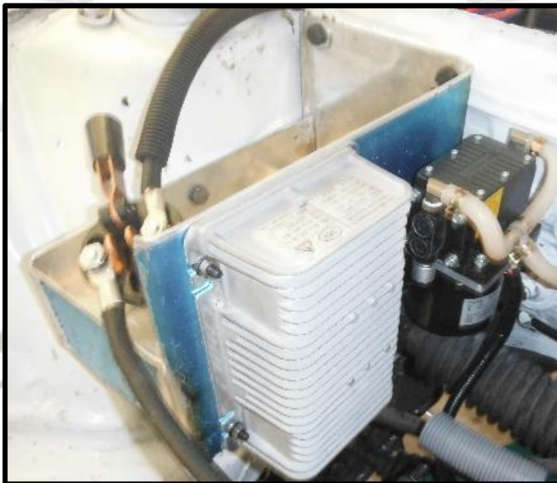
Figura Nº 53: Soporte de Batería extra convertidor DC/DC y bomba de Vacío Fuente: Elaboración propia
