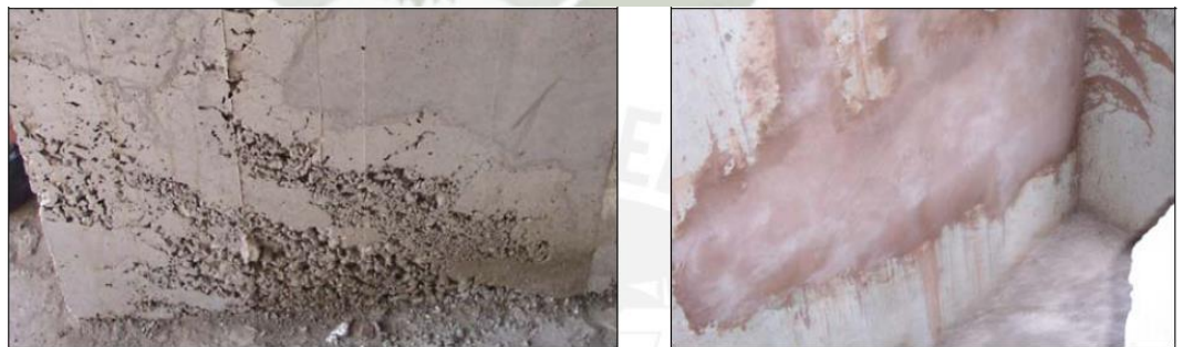
Figura 8.126: Imperfecciones previas al resane y muro luego del resane. (Fuente: Internet)
